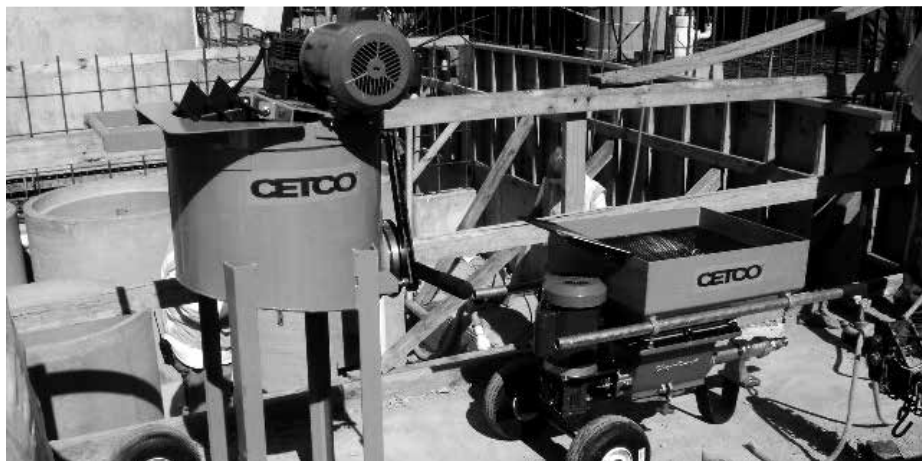
Figura 2: bomba y mezclador CETCO con motor eléctrico de 1 caballo de potencia
