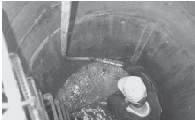
APLICACIÓN A TRAVÉS DE MUROS INTERIORES: BEN TOGROUT® inyectado al exterior de una zona de alcantarillado a través de orificios pretaladrados empleando una varilla de inyección corta
